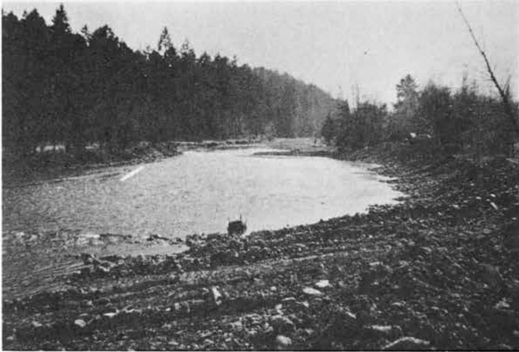
9) Die Innerste kurz vor Langelsheim (3 Bilder), nach dem Bulldozer kurzerhand zur Rettung der Abwasserleitung Oberharz einen Damm aufgeschoben haben. Diese Sammelleitung, kostengünstig parallel zum Flußbett (!) verlegt, wäre beim März/81 Hochwasser durch Ausspülung und hohen Innendruck fast gebrochen.
